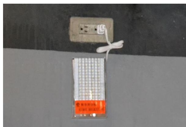
圖143 緊急照明系統
