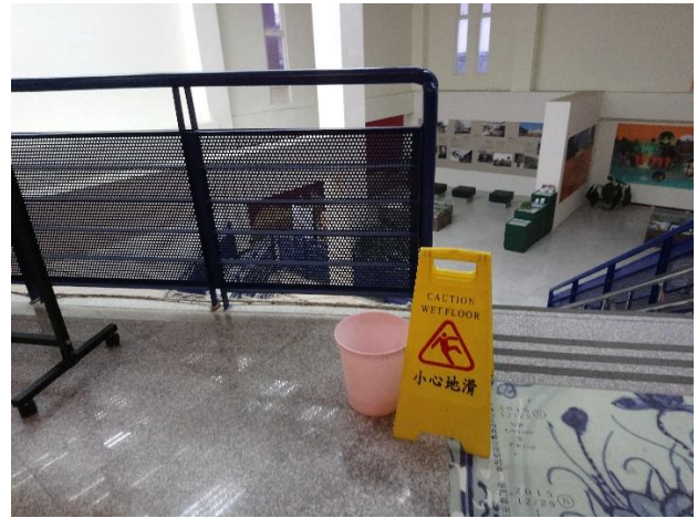
圖6 大廳漏水問題
