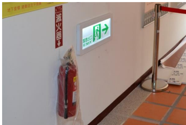
圖141 滅火器及緊急出口告示牌
