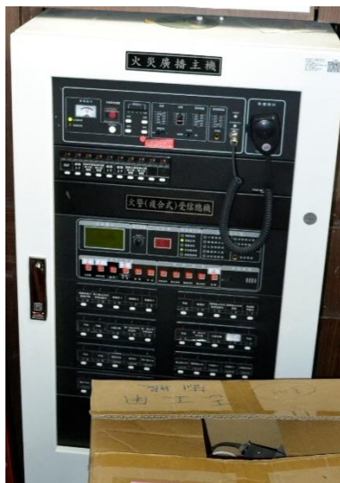
圖138 火災廣播主機位於服務台後方辦公室
