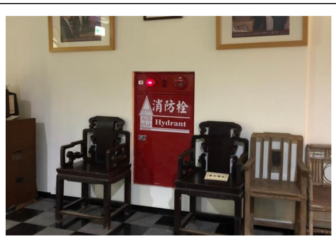
圖 252. 烈嶼鄉文化館展示館內消防栓
