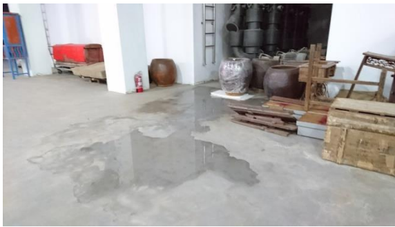
圖127. 庫房積漏水（一）
